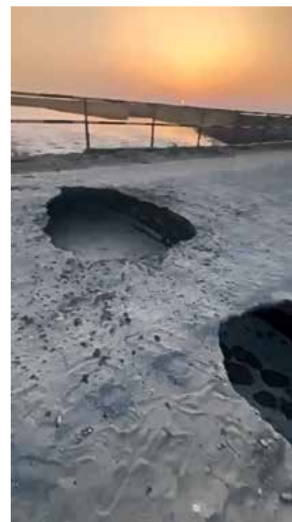
РАЗМЫВ ДАМБЫ ПАВОДКОВЫМИ ВОДАМИ
