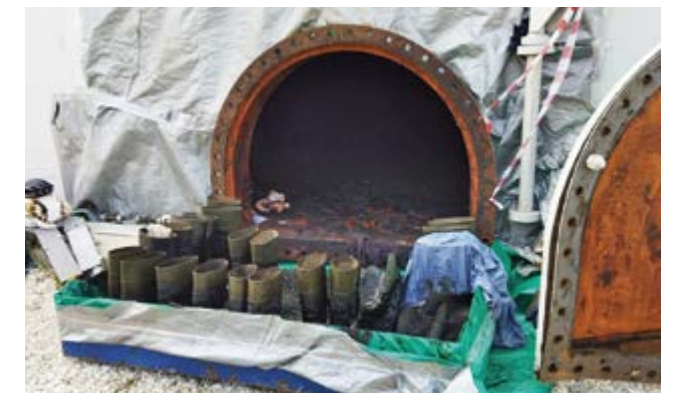
Зачистной люк резервуара
